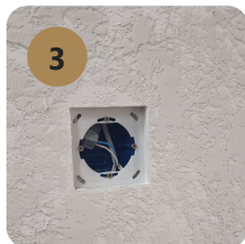
Отделка по кромке штукатурка и краска без стыка
